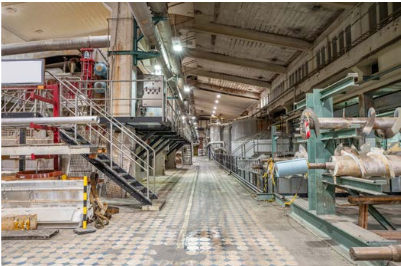
Till vänster ligger idag PM 11:s blekeri. Det är byggt i tre etapper, den första 1988 och den senaste 2001. Till höger ligger PM 12:s blekeri, det är upprustat i två etapper. I den första etappen installerades Hedemora pressar, i den andra etappen flyttades pressarna hit från Vargöns bruk när det lades ner 2008.
